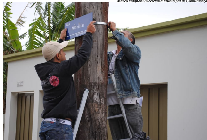
Levantamento da Unasab's apontou necessidade de instalação de quase 2 mil placas em mais de 40 bairros
