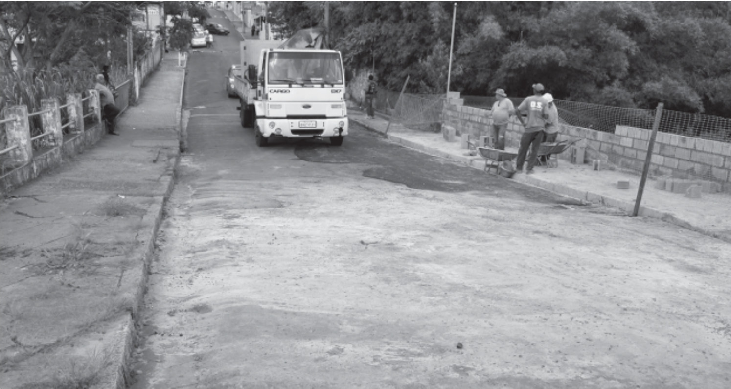
Passagem encontrava-se interditada desde julho do ano passado
