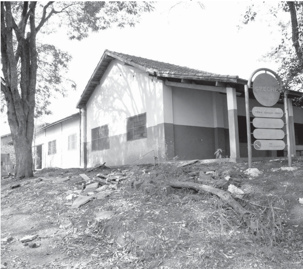
Desgaste natural do tempo contribuiu para surgimento de problemas como rachaduras
