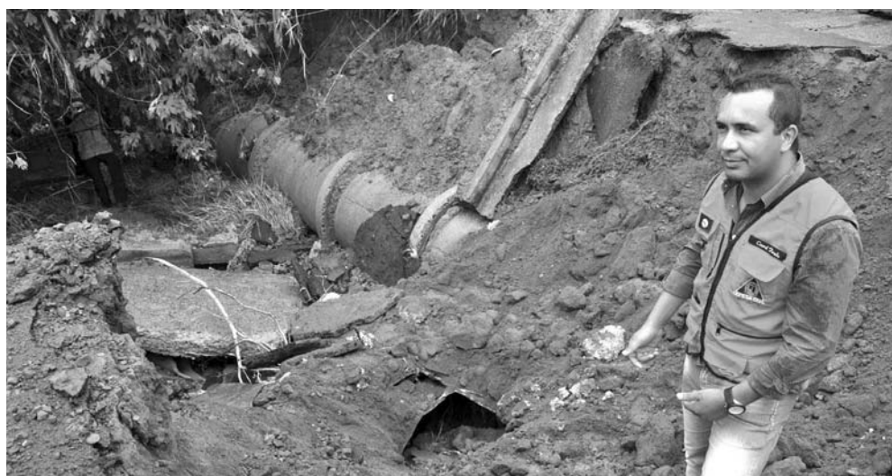
Volume de água rompeu sistema de galeria em Rubião
