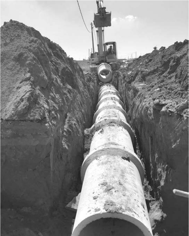
São 324 metros de tubulação para captação da água das chuvas
