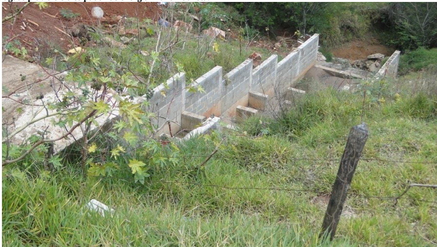
Foto 11. Galeria de águas pluviais e dissipador de energia – Vila Paulista.
