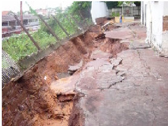
Creche da AAMI foi bastante danificada
