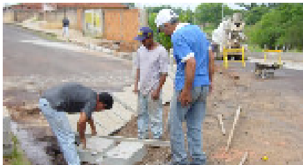
Canaletas (concreto): cruzamento da Cel.Fonseca
