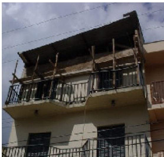
Chuva casou grandes danos no prédio
