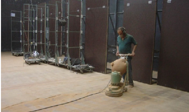
Reparos são necessários para oferecer mais conforto de artistas e platéia
